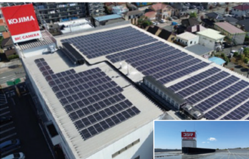
店舗屋上に設置した太陽光パネル
