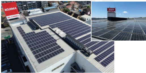
店舗屋上に設置した太陽光パネル
