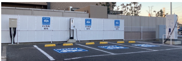
コジマ×ビックカメラ宇都宮本店のEVカー充電器
