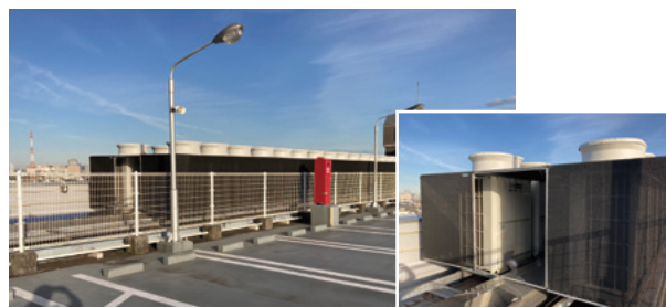
エアコン室外機に設置した遮熱ネット
