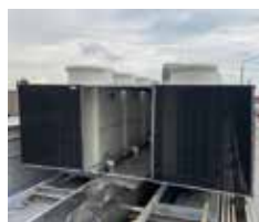
エアコン室外機の遮熱ネット
