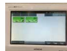
デマンドコントローラー
