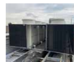
エアコン室外機の遮熱ネット
