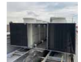
エアコン室外機の遮熱ネット
